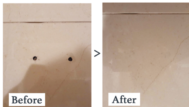
大理石の施工間違い穴
