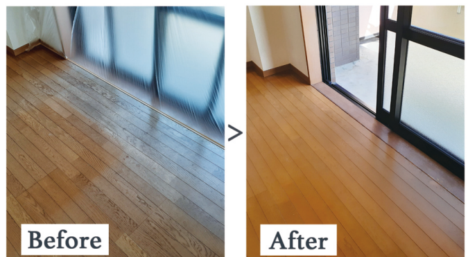
突板フローリングの日焼けによる退色
