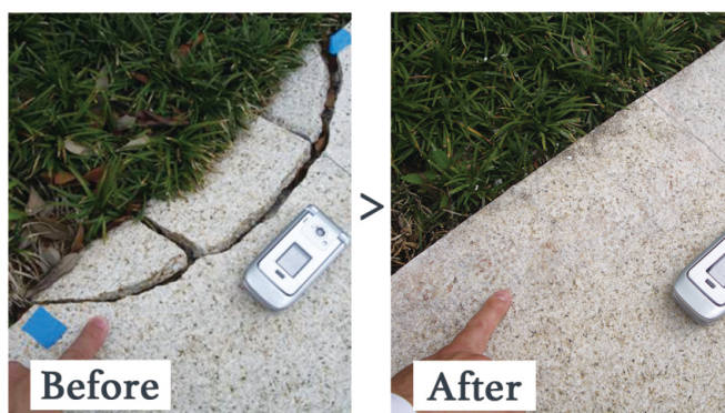
タイルの大きな割れ
